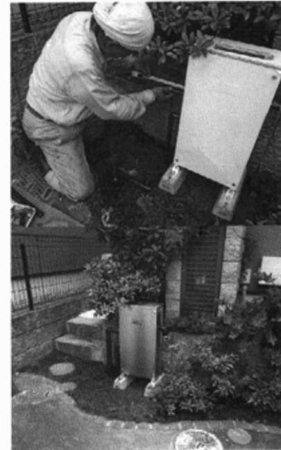
戸建て用の設置例
